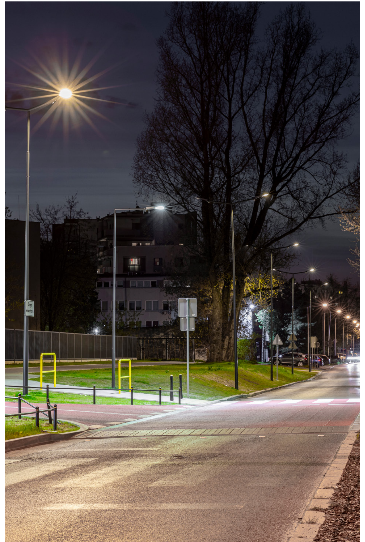
Zastosowanie opraw Astra LED Alu
