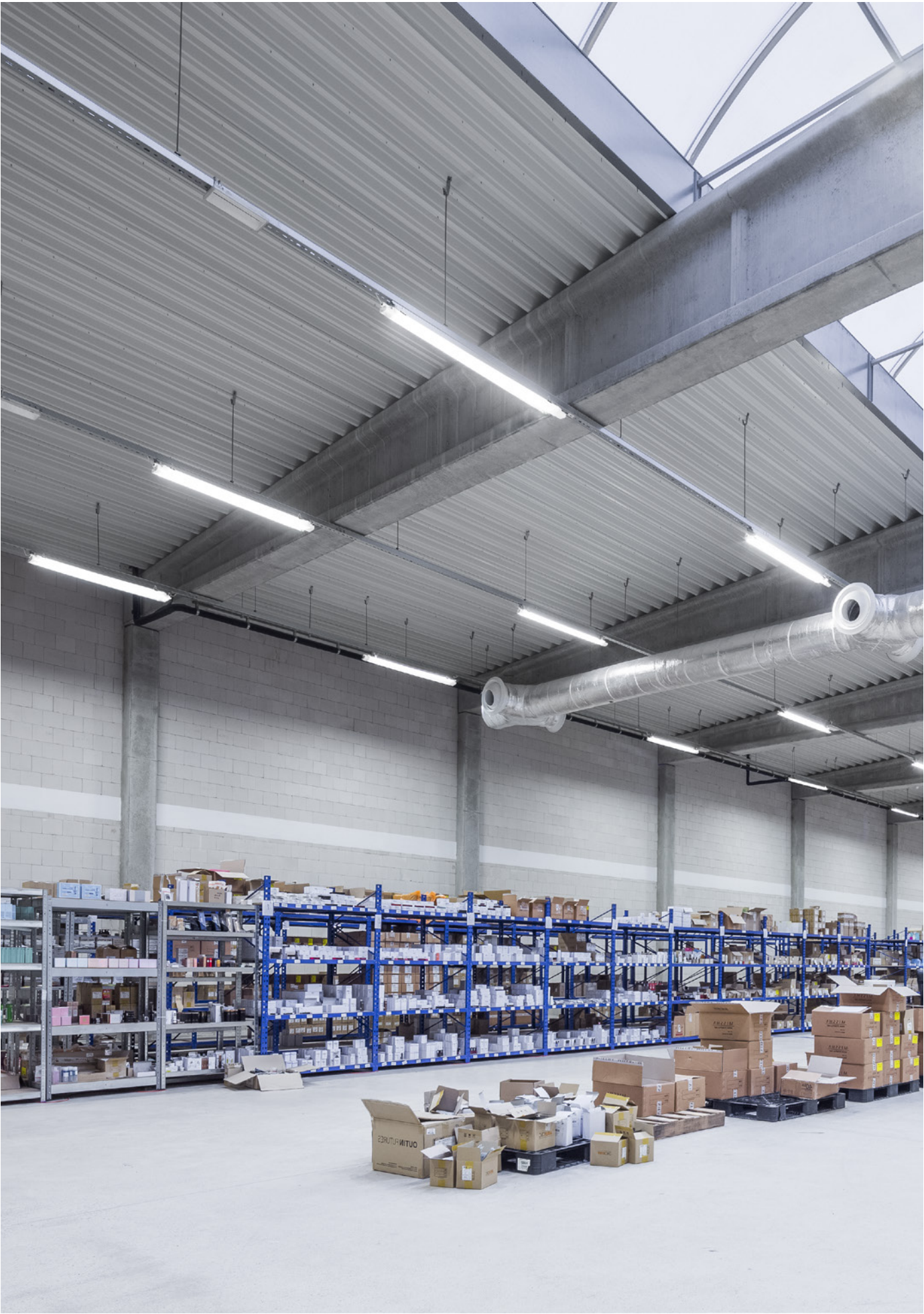
Zastosowanie lamp Mimo 2 LED w hali magazynowej
