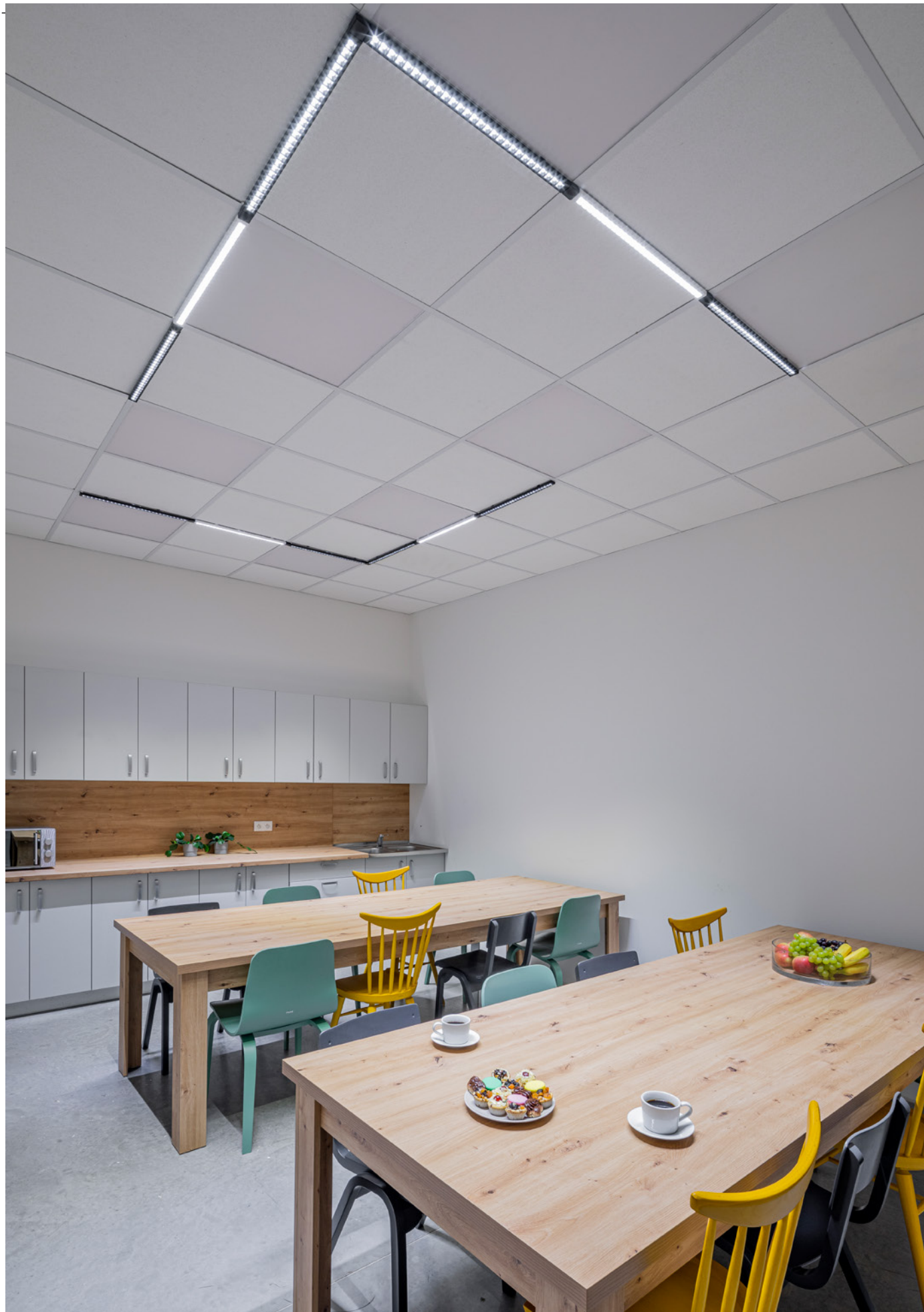
Zastosowanie systemu Terrano w kuchni biurowca
