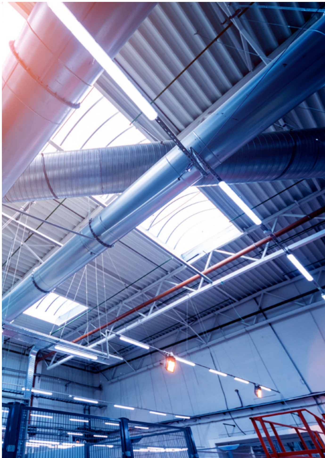
Zastosowanie lamp Tytan 2 LED Endura w hali magazynowej
