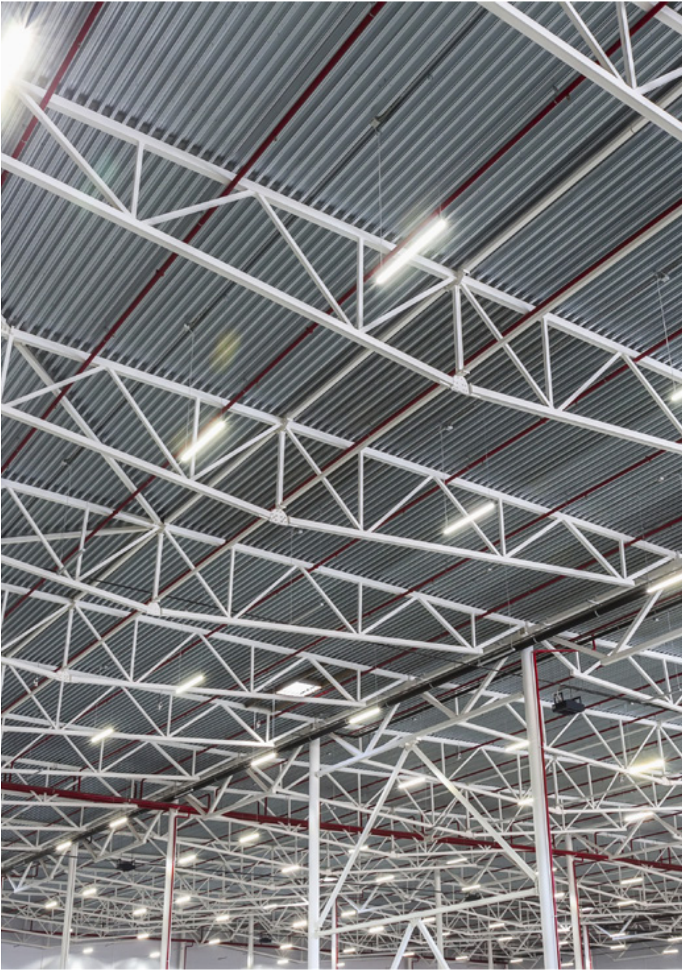
Zastosowanie lamp Tytan LED Multi w hali magazynowej
